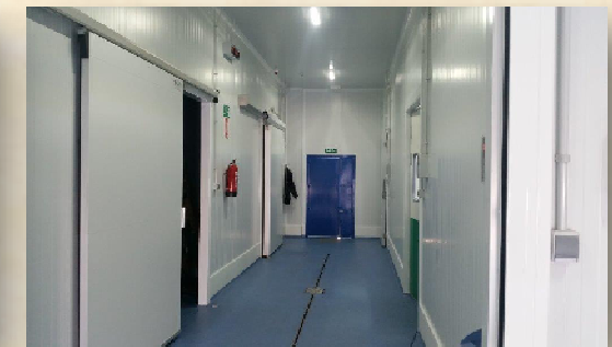
Detalle de zona de cámaras frigoríficas
